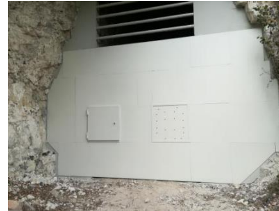
Porte blindée anti-intrusion installée sur une ancienne carrière du site dans le cadre d'un contrat Natura 2000
