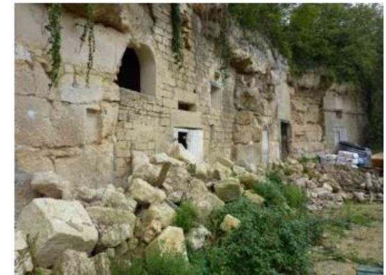
Entrées murées n'empêchant pas l'intrusion et le dérangement
